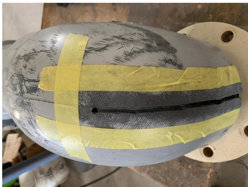
Obr. č. 7 PVC potrubie s pripraveným povrchom na zalepenie, so zväčšením praskliny do tvaru „V“ a ukončenou prasklinou zavrtaním
