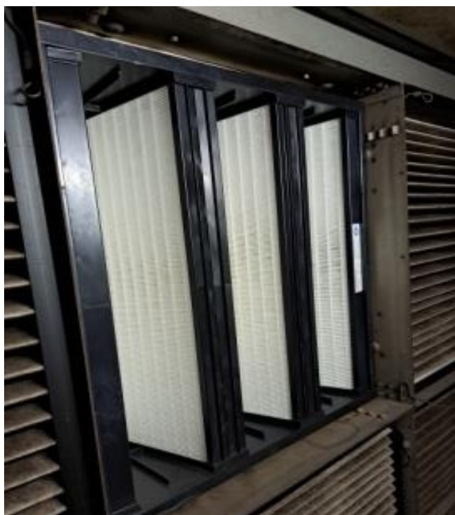
Obr. 2 Výmena filtrov vzduchotechniky vypaľovacej pece
