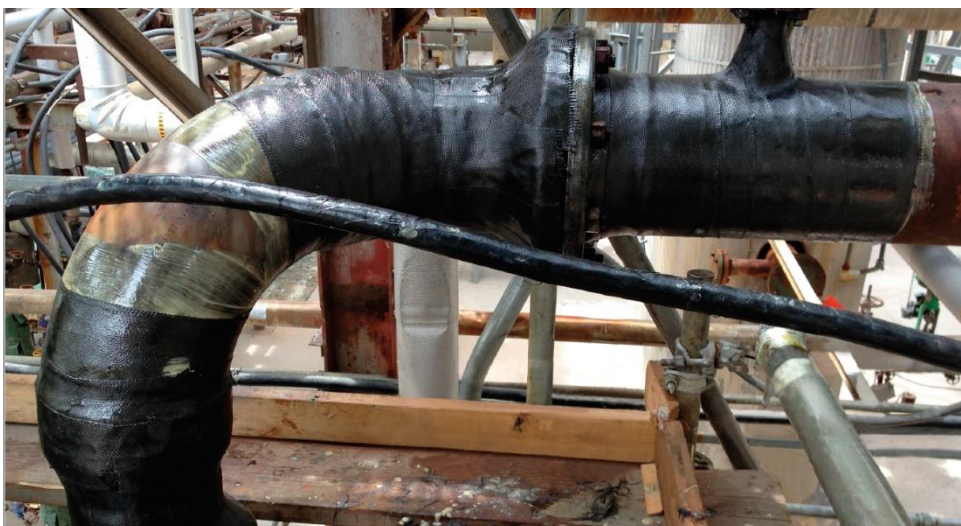
Obr. 19 Zosilnenie hrúbky steny oslabenej vnútornou koróziou kompozitnou bandážou
