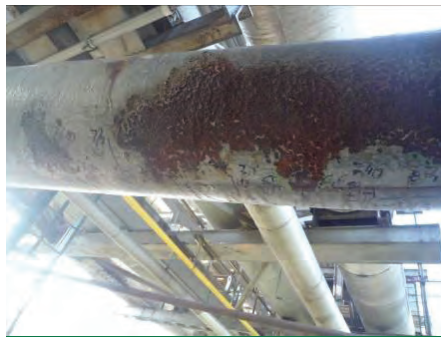
Obr. 2 Skorodovaná časť potrubia
