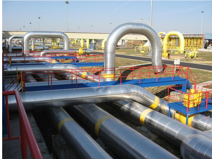
Obr. 2 Potrubný dvor kompresorovej stanice
