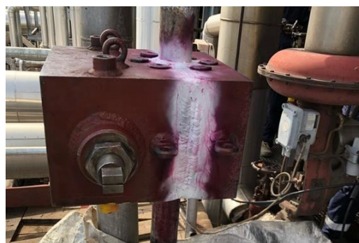
Obr.13 NDT uzatváracieho bloku po navarení
