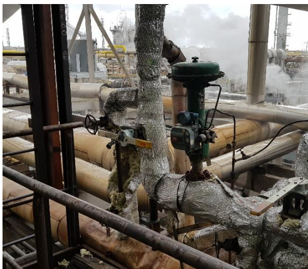
Obr.1 Poškodený uzáver prívodu kotlovej vody
